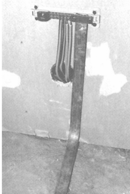
Figuur 45. Aansluiting op de vereffeningrail in de kelder.
